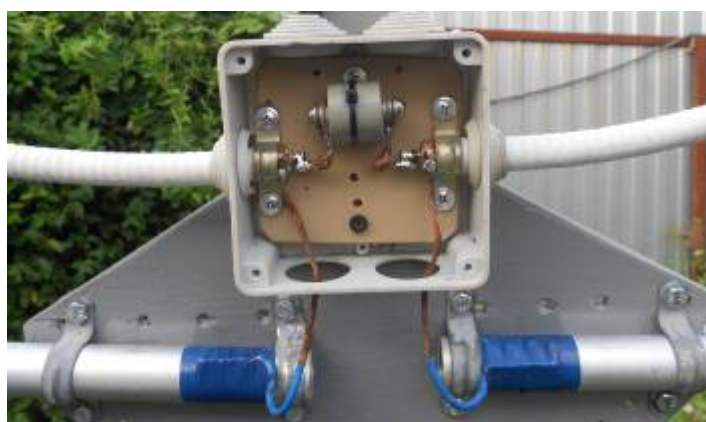
Рис. 7. Монтаж конденсатора С1.
